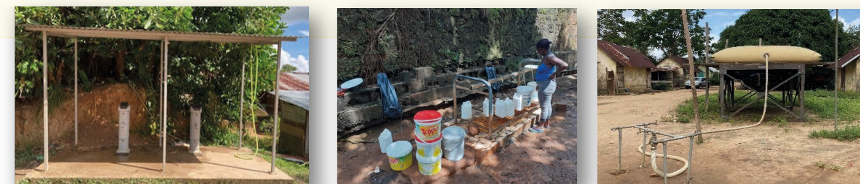
Dispositifs d'accès à l'eau potable
